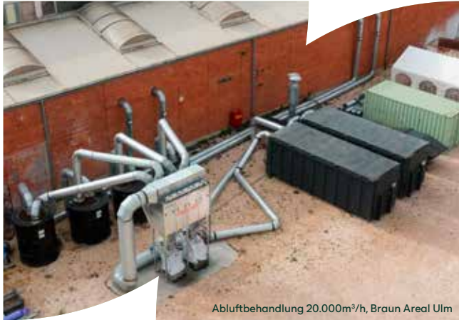
Abluftbehandlung 20.000m³/h, Braun Areal Ulm
